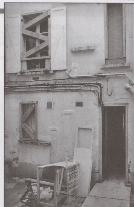
Les murs de l'immeuble du 26 rue Berthe ont dû être étayés.
